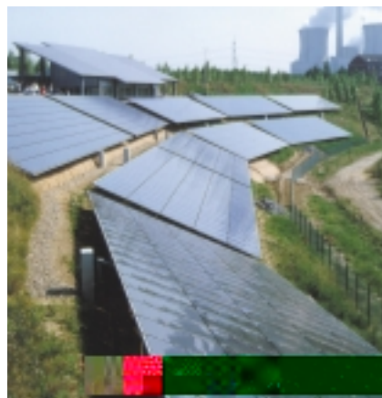
Die Photovoltaikanlage Neurathersee, RWE AG Essen
